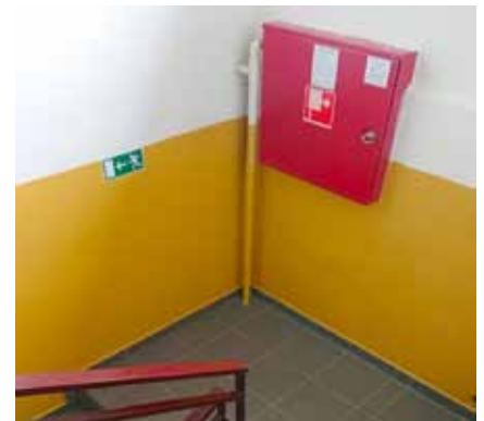
Schodisko musí byť z bezpečnostného hľadiska priechodné.
